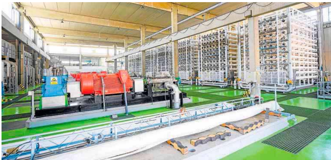
Planta desaladora de Almería. R. I.
